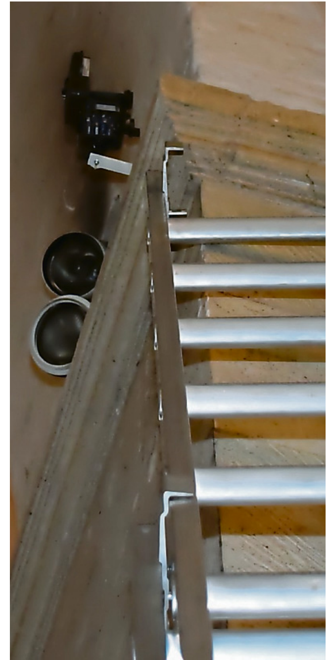
Gut fünf Meter geht es mit der Leiter nach oben, um an den Kamerachip zu kommen.
